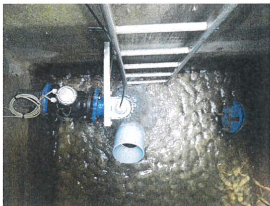
Vue du dispositif actuel de mesure en continu : débitmètre électromagnétique installé sur la conduite d'adduction
