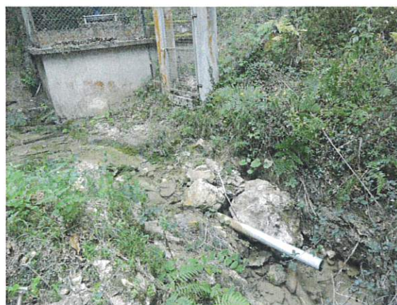
Vue du tuyau PVC d'exhaure des trop-pleins dans le ruisseau Capelin
