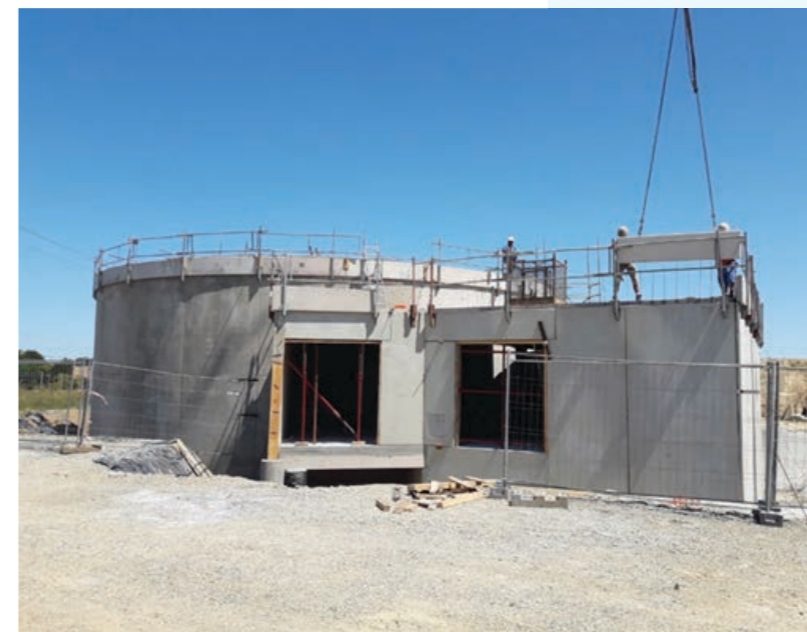
Réservoir et équipements pas encore mis en service
